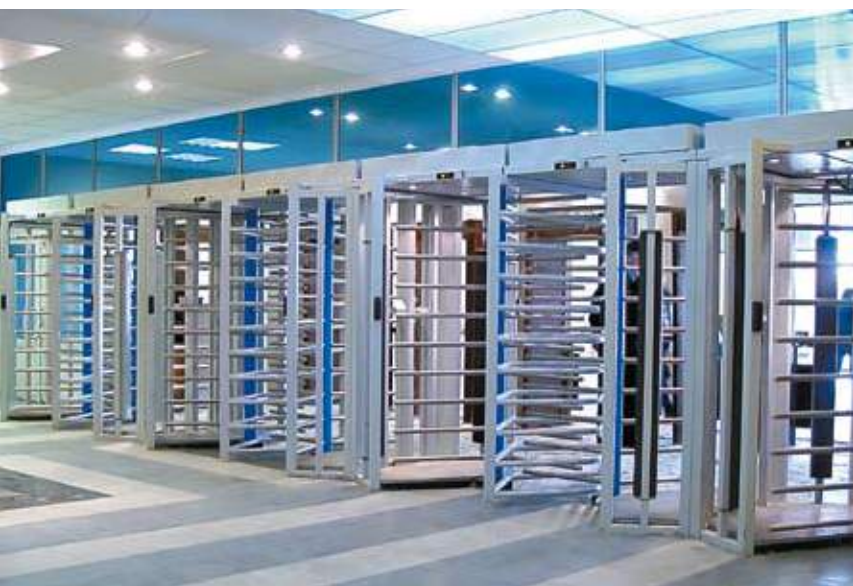
Рисунок 1 – Внешний вид турникетов, установленных в ряд на проходной особо важного объекта
